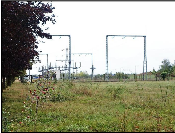
Photo 26 : Poste électrique (Rainette, 2020)
